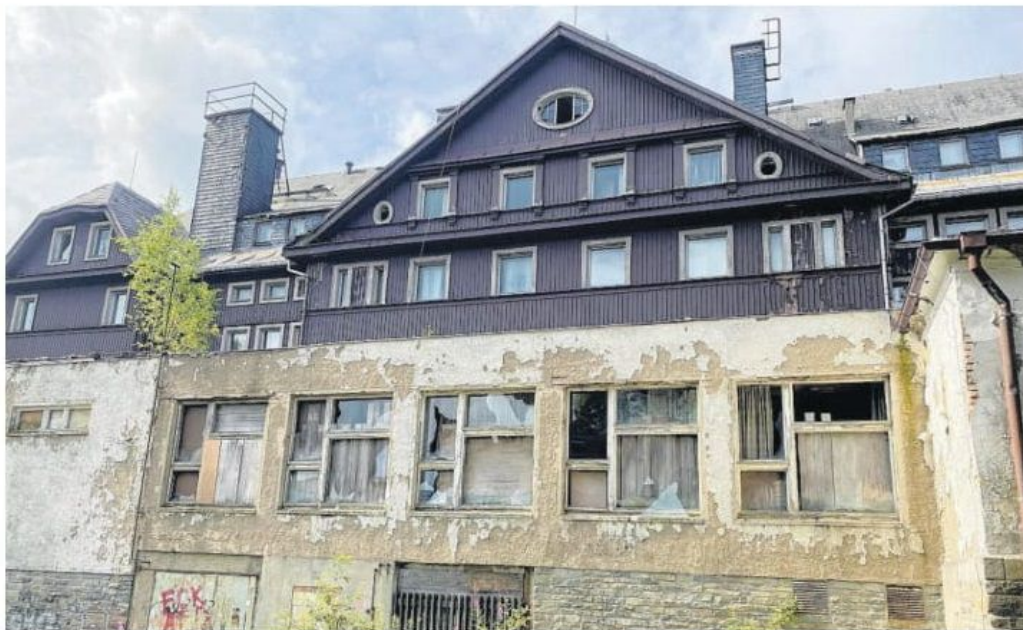
Der jahrelange Verfall hat sichtbare Spuren am alten Sporthotel in Oberwiesenthal hinterlassen. Das Foto zeigt die Seite zum Innenhof.
